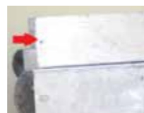
Ausencia de calzo
