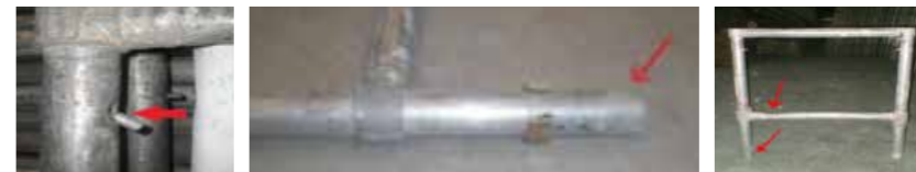
Tetones rotos en laterales
