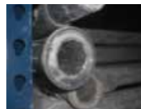
Golpes en el interior del tubo
