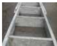
Suciedad en peldaños
